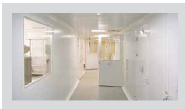
Двери и окна в чистом помещении
