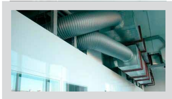
Система вентиляции в чистом помещении
